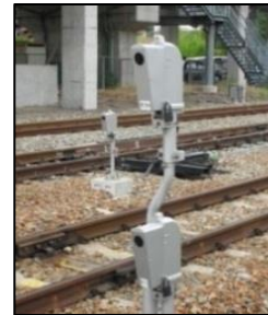
踏切障害物検知装置
