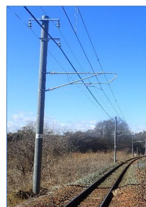
・更新した電化設備
