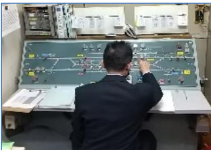
・補助制御盤訓練
