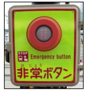
踏切支障報知装置
